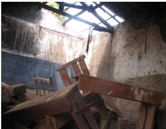
Dieses Klassenzimmer ist wegen Einsturzgefahr geschlossen.
