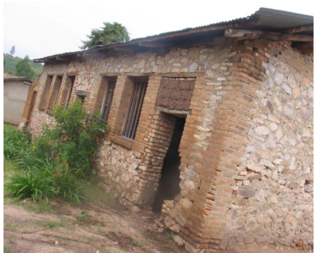
Kaum zu glauben: In diesem baufälligen Schulgebäude wird noch unterrichtet.
